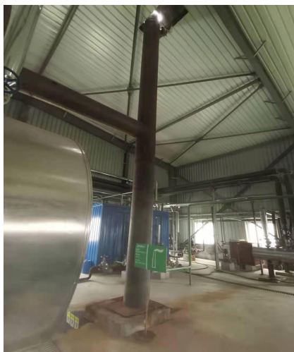
DA004 废气排放口及标志牌
