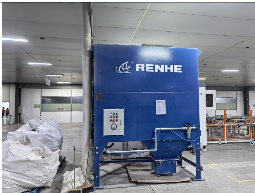
图 3-8 本项目打磨机、斜切打孔机配套的布袋除尘器
