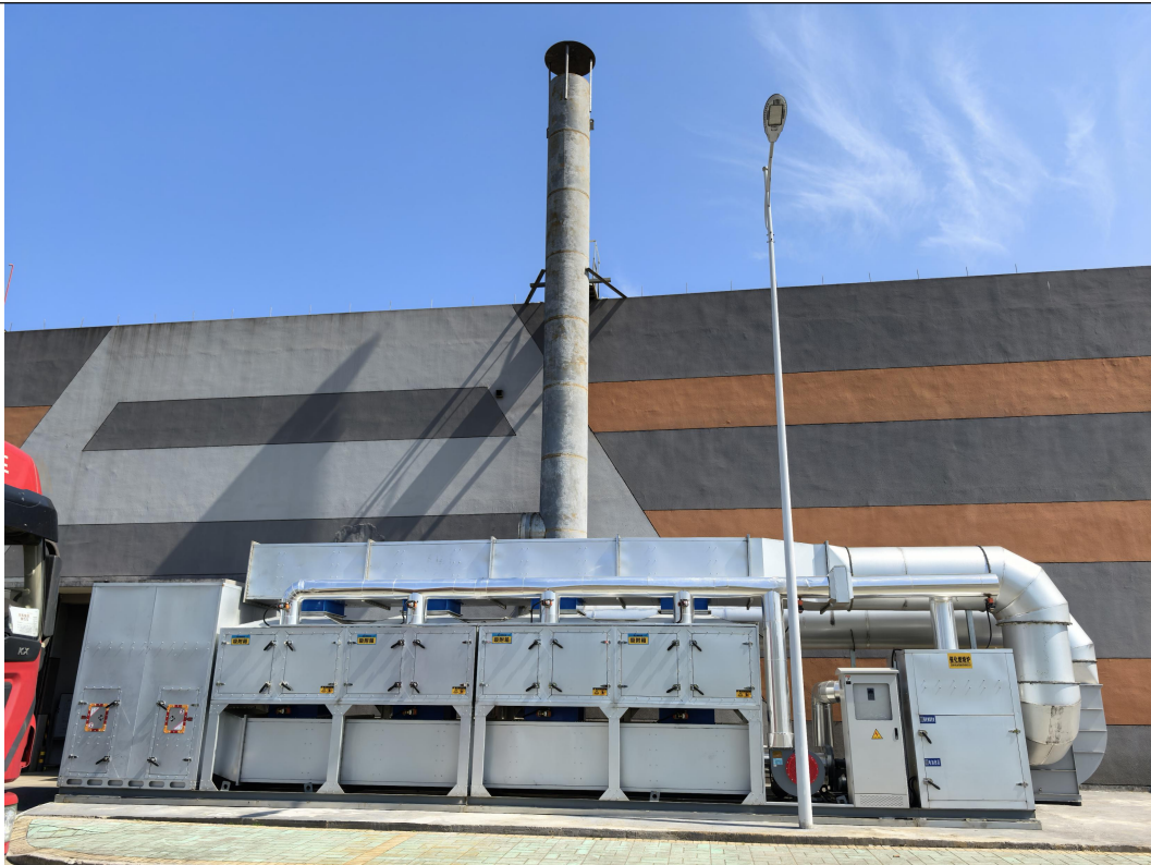
图 3-10 本项目涂装废气治理设施（吸附棉过滤+活性炭吸附装置+脱附催化燃烧（电加热））
